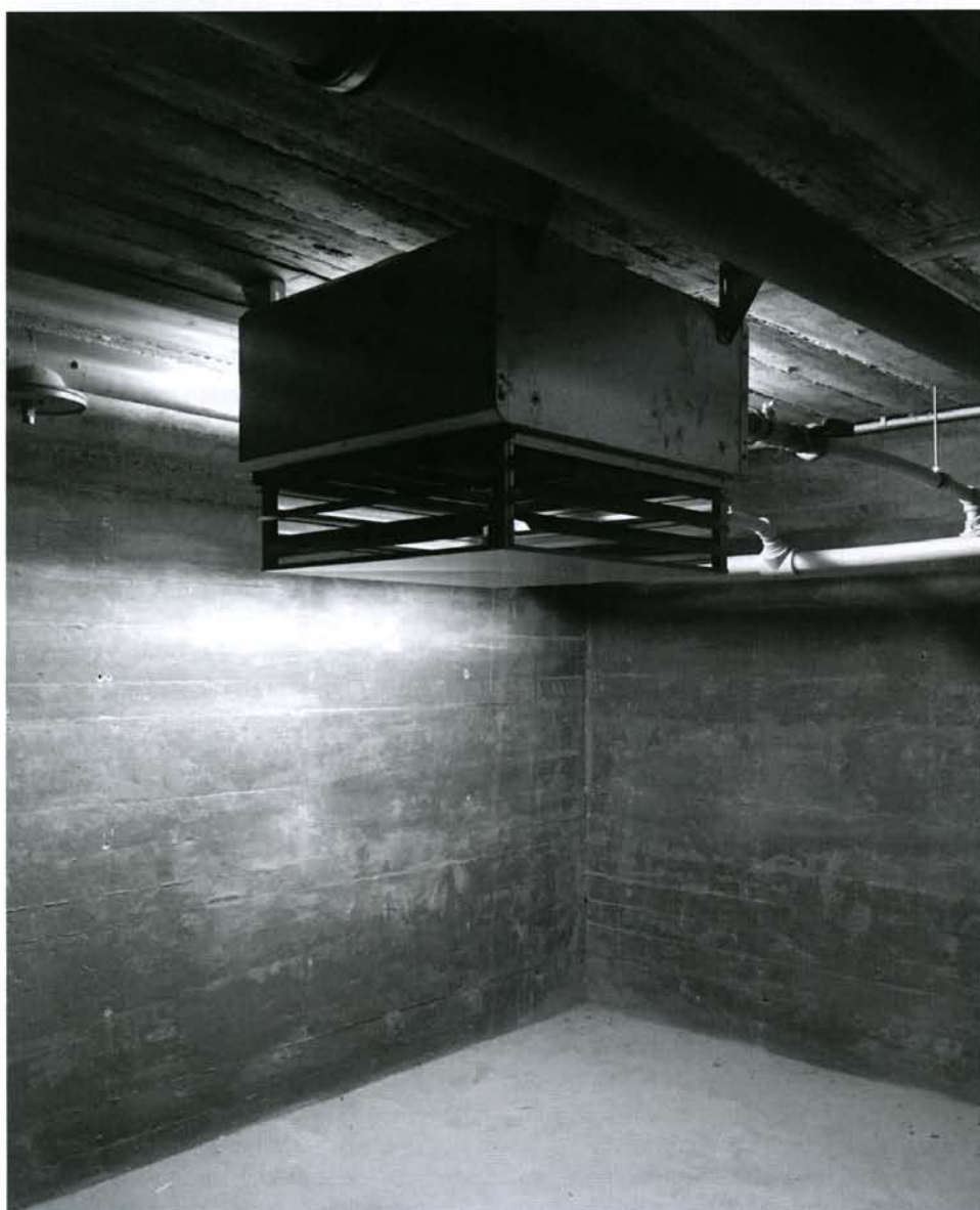
6 Lufterhitzer im ehemaligen Bunker im Kellergeschoss (Claudius Pfeifer, Berlin)
